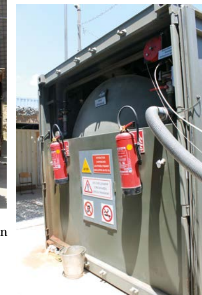
Cuve de stockage du SEA déployé sur le théâtre afghan © M. Delaporte, KAIA, Afghanistan, juin 2012
